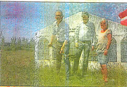
KAB er byggeforretningsfører på det nye byggeri i Trekroner Øst, så administrerende direktør Jens Elmelund fik lov at tage det første spadestik i overværelse af Berit Breiner, formand for Høje Taastrup Boligselskab, og Tomas Breddam (S), formand for plan- og tekniskudvalget.
